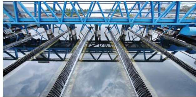
徐泾水厂扩建后制水生产线
